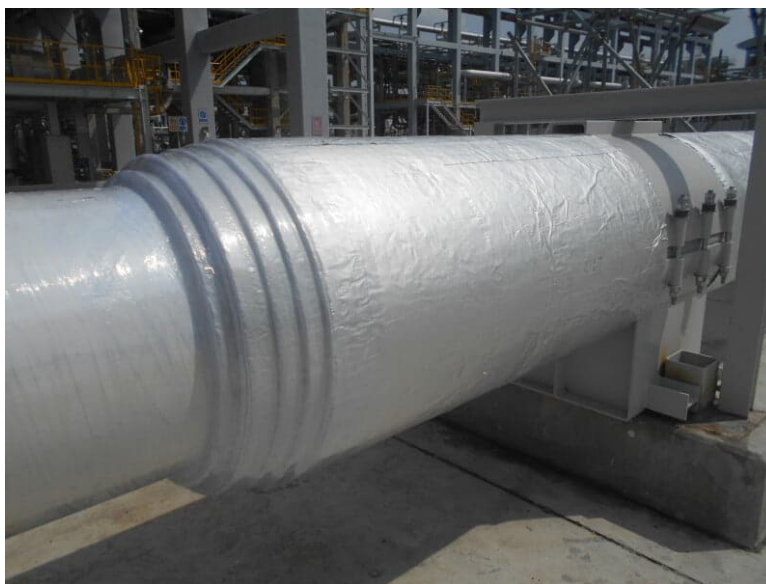
شکل ۳. نمایی از عایق‌کاری لوله‌های خطوط سرد و گرم
